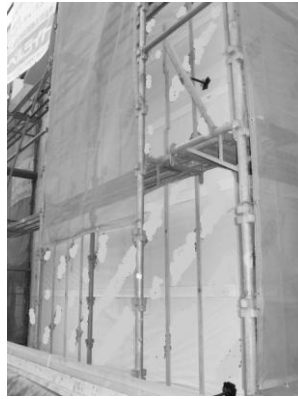
サッシが取り付かない現場
