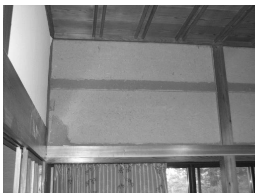
和室の壁の剥離・落下:これは、昔の小舞(こまい)壁ですが、中塗りとその上に塗った仕上げ壁が一体となって、剥離・落下した状態
