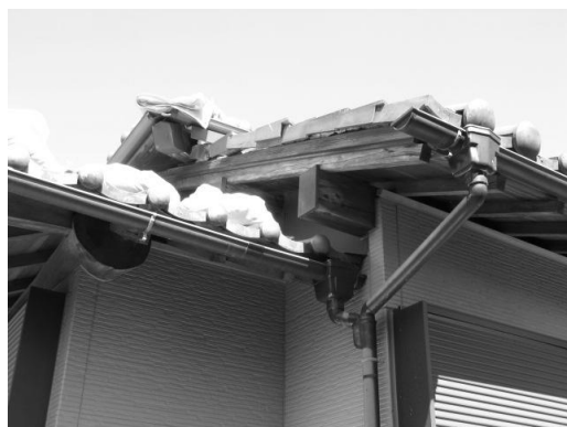
屋根瓦の崩れ
