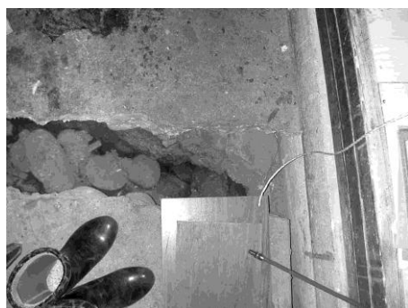
玄関土間の地割れ・陥没
