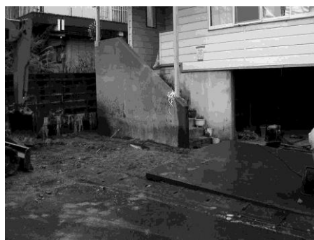
液状化で建物が不等沈下(階段高さに着目)
