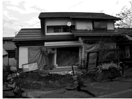
盛土と切土境界に建つ家 (地盤破壊)
