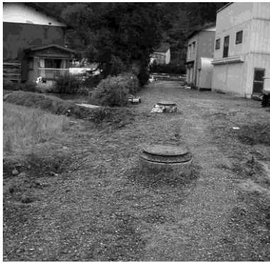
液状化でマンホールが突出 (建物があったら?)
