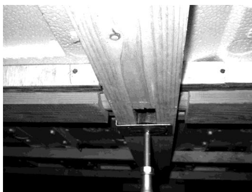
古材の使用(欠損材)
