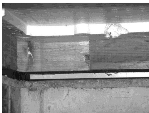
基礎パッキンとアンカーボルトの欠落
