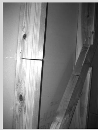
間柱のそりを戻す為に、鋸目を入れ切断された間柱
