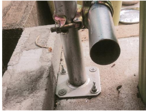
柱脚の固定ベースとアンカー
