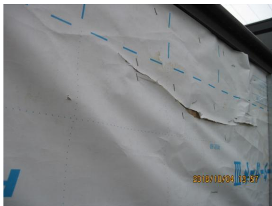
破れたままの透湿防水シート
