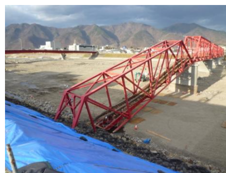
上田電鉄別所線 鉄橋が崩落
