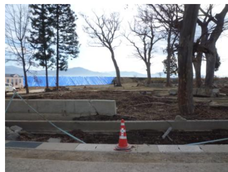
決壊現場と守田神社 跡 (ブルーシートの所が決壊)
