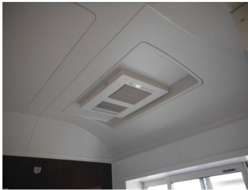
ユニットバスの暖房設備の例
