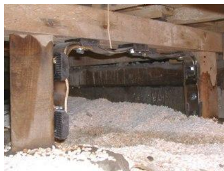
床下の土の上に調湿材(白い直径5mm程度の粒)が敷かれた事例
