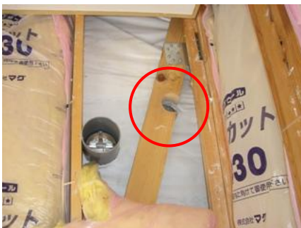
エアコン配管用の穴を開け、筋交いに穴を開けた事例
