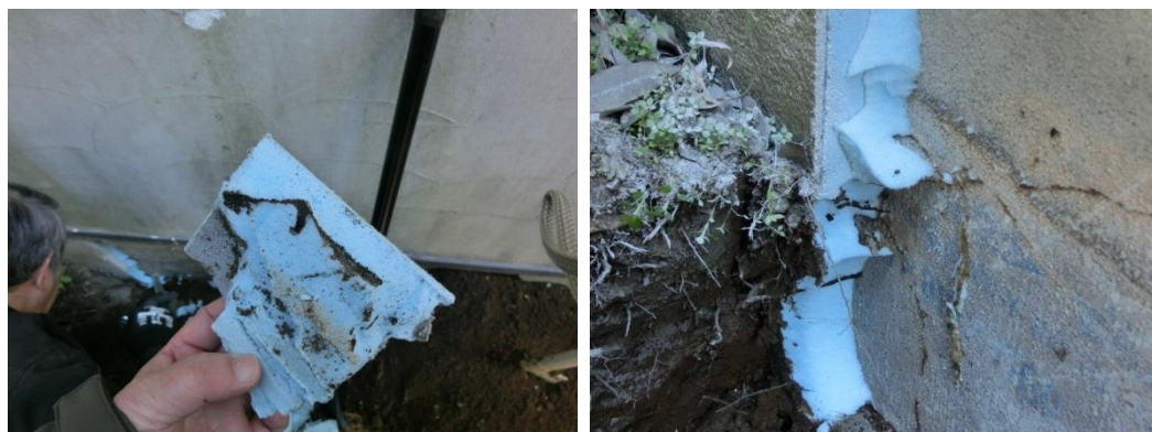
基礎周辺の断熱材に現れた蟻道
