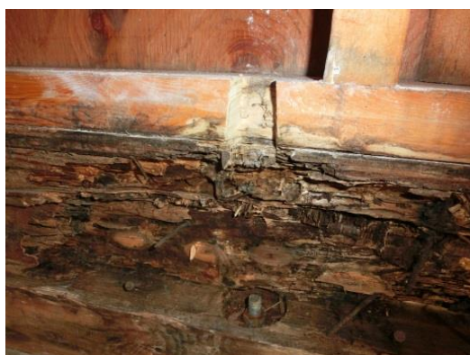
土台周辺に現れた蟻道(内側)
