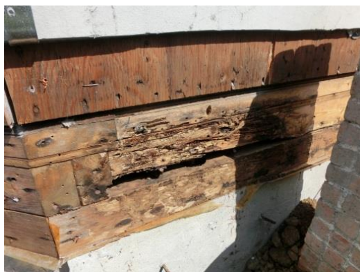
土台周辺に現れた蟻道（外側）
