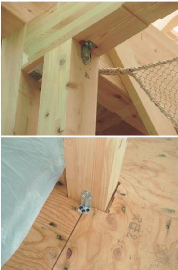
写真1(柱上下)(現状) ビス(45)3+3
