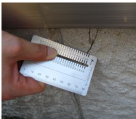
(不同沈下による変形傾斜の起点付近に生じた基礎立ち上がり部のひび割れ)
