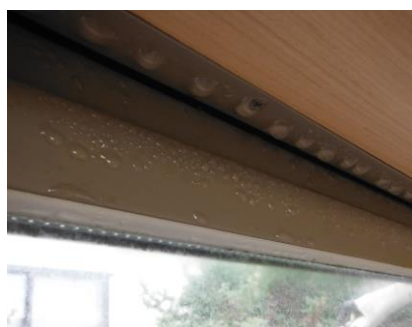
アルミ樹脂複合サッシ+複層ガラスのガラス面・框面・サッシ枠に発生した結露
