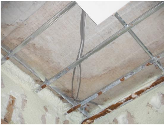
2 階床スラブ下面の断熱補強の未施工による、スラブ下面の水浸みと軽天材の錆
