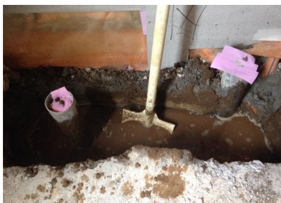
浴室基礎コンクリート内の水溜まり
