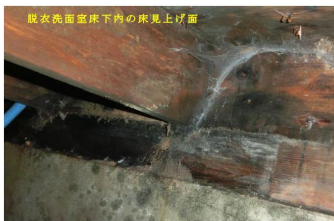
漏水のため、土台や根太等も無残な状態になっている
