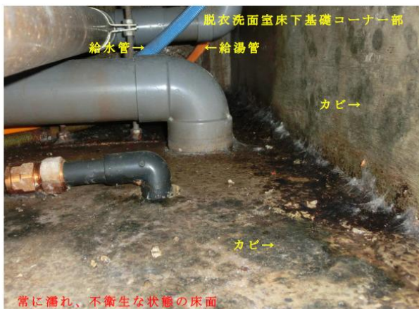
漏水のため、設備配管の無残な状態になっている
