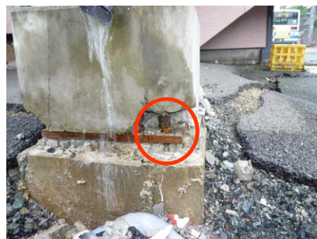
⑩益城町 鉄骨造住宅 柱脚アンカーボルトの伸び
