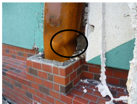
⑨益城町 鉄骨造店舗 柱・局部座屈
