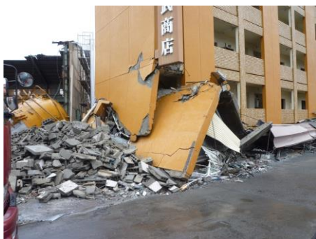
⑧東区 店舗併用住宅 C B (コンクリートブロック) 外壁破壊
