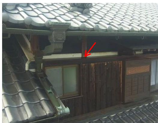
長押上部の水切り板と柱（現し）の 取り付けより雨が浸入
