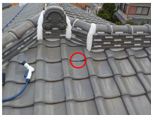
平瓦の重ね部分より雨が浸入
