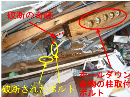
⑦ ホールダウン金物のボルト破断
