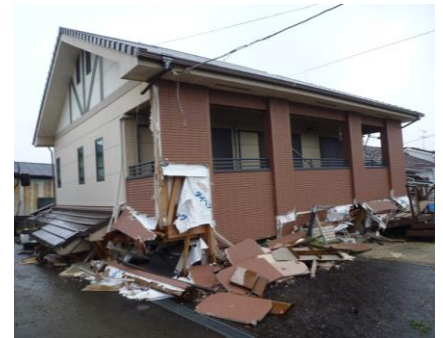
⑥ 1階が層崩壊した住宅
