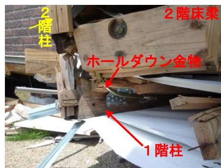
③ 1階が層崩壊した2階床梁と柱の接合部
