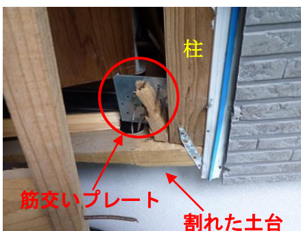
④ 筋交い下端接合部の破壊
