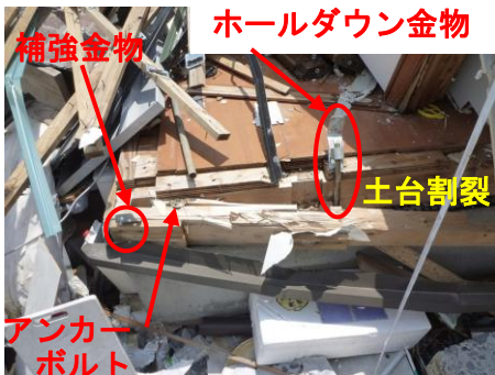
① アンカーボルト、ホールダウン金物による断面欠損部より土台が割裂
