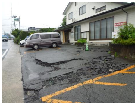
① 地盤表層部の変状 (駐車場)
