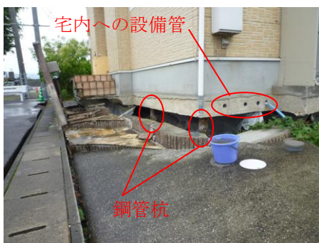
⑦液状化による鋼管杭の浮上り
