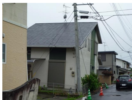
⑧液状化により傾斜 (べた基礎と思われる)
