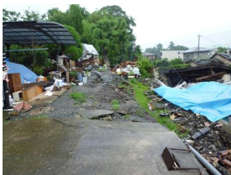
② 地盤表層部の変状 (崖地)
