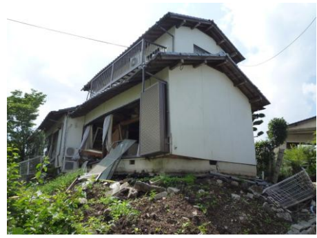
④盛り土地の擁壁崩壊 (べた基礎が上家を支持)
