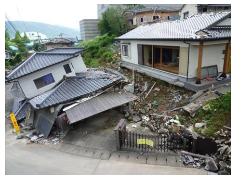
⑥盛り土地の崩壊 (べた基礎が上家を支持)
