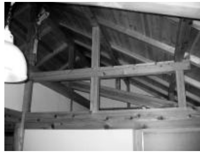
見学したお宅の小屋裏の様子。小屋組材は特に良好な状態だった。
