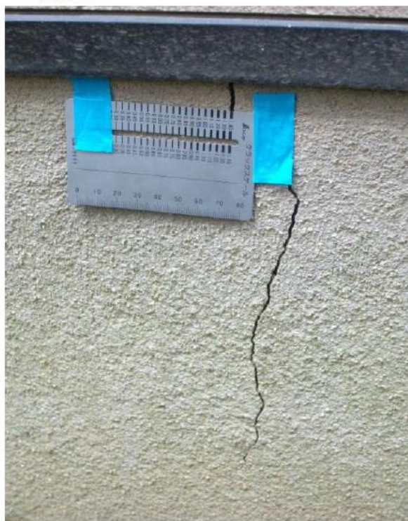
基礎立上り: 亀裂幅 1.4 mm
