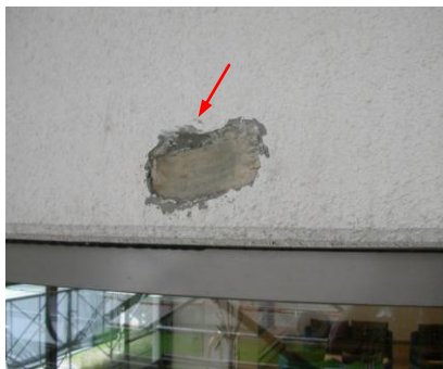
打診検査によりコンクリート 躯体(梁)内に木片混入が発覚。
