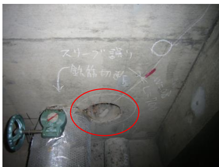
間違えて空けたスリーブを起点に躯体のひび割れが発生。
