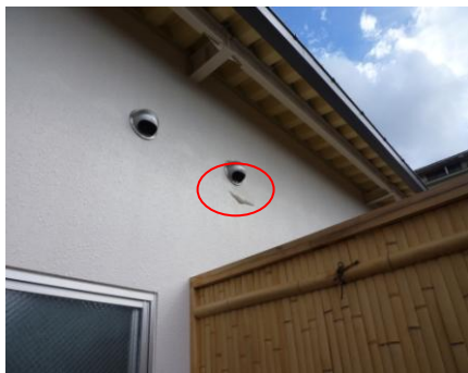
塗装の膨れの調査を行ったら、 下地や断熱施工不良が発覚。
