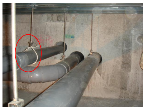
排水配管の支持固定に規定の 固定バンドを使用せず、被覆鉄 線を用いている。
