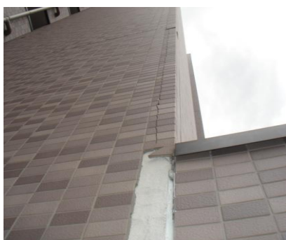
外壁タイルが割裂、剥落している。
