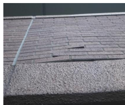
外壁タイルが剥落寸前。
