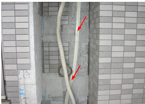
タイルを剥がすと耐震スリットの 位置ずれ、湾曲が発覚。耐震性能を 著しく損なう瑕疵。
