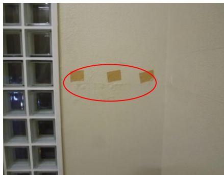
壁仕上げの膨れから躯体のひ び割れ、雨漏りが発覚。
