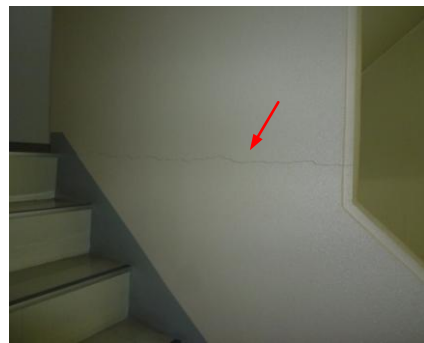
コンクリートの打継ぎ不良に よるひび割れ。
