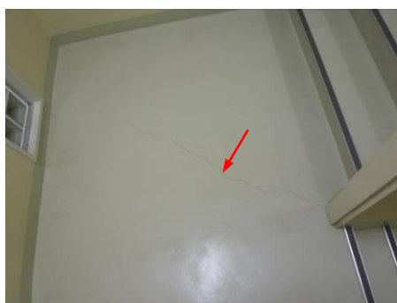
階段室床面のひび割れ。隠れた瑕疵が見つかることもある。
