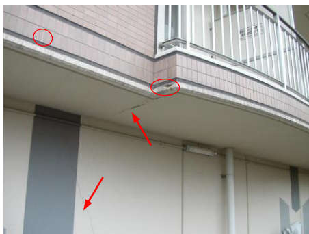
外装のひび割れ、部分欠落、白華現象も見受けられる。
