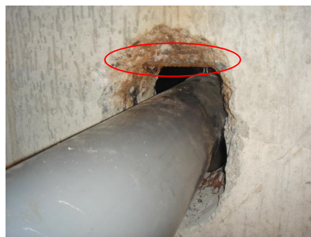
後施工貫通。鉄筋も露出したまま放置されている。
