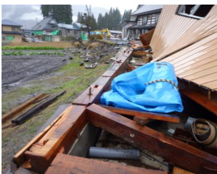
土台と柱が緊結されていない
