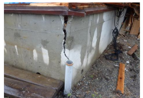
基礎立上り部に鉄筋がない
