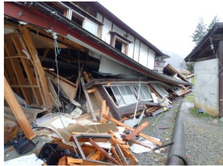
木造・土蔵など構造特性の異なる建物の連結、増築を繰り返している
