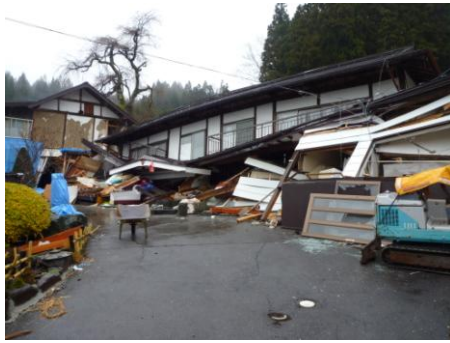
1階は壁量不足、2階は重い。上下階の筋交いバランスも悪い。
