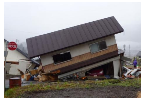
1階が大空間で柱が少なく平面的・立体的に筋交いバランスが悪い。
