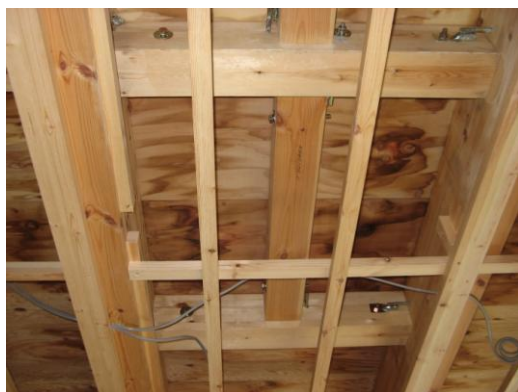
床の構造用合板の変色
