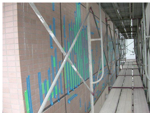
外壁タイルの浮き
