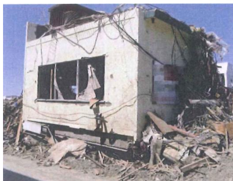
2階建て建築物の層崩壊
