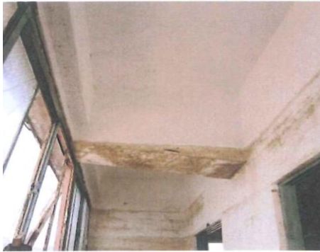
建物内部の水の汚れの痕跡
