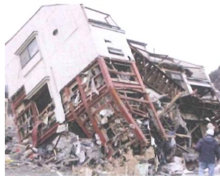
3階建てS造の1階柱脚部の引き抜けおよび1階柱の座屈による転倒
