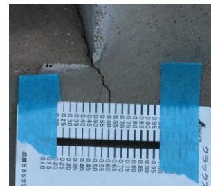
立ち上り基礎の亀裂幅0.6mm
