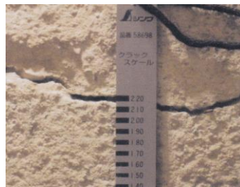
べた基礎スラブの亀裂幅2.2mm
