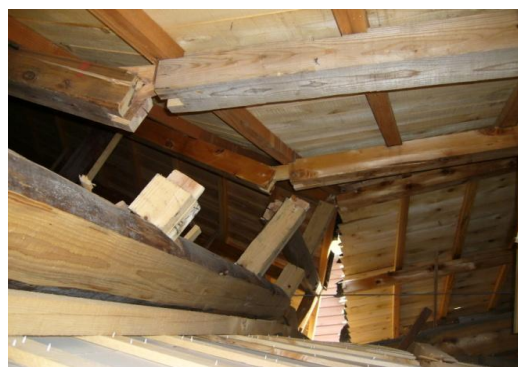
写真B(脆弱な仕口・継手部)
