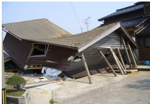
写真A(屋根が折れた家)
