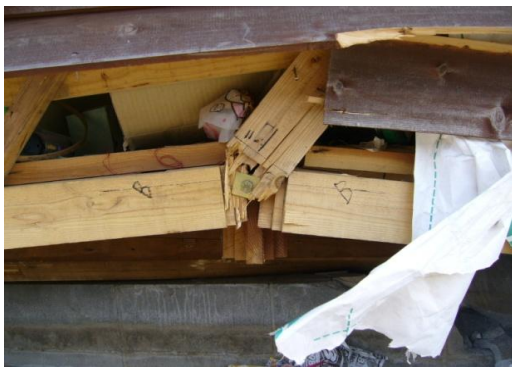
写真C(脆弱な仕口・継手部)
