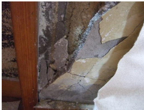
下地モルタルの剥離
