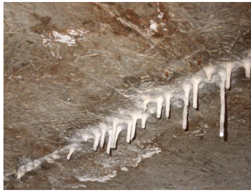
鉄筋コンクリートに生じた白華現象
