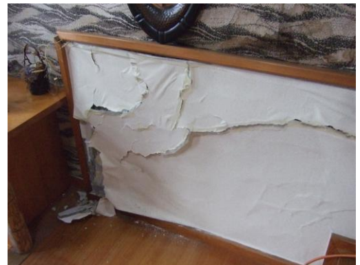
壁クロスの浮きと割れ
