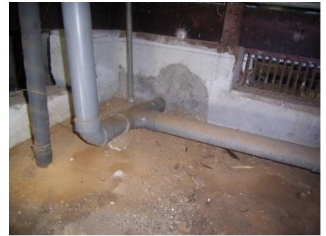
欠陥事例写真⑧
