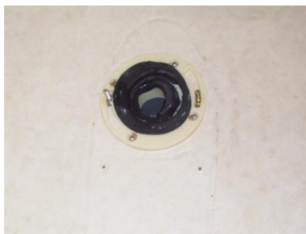
欠陥事例写真③
