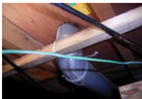
欠陥事例写真②
