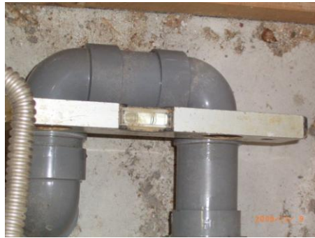
欠陥事例写真⑨
