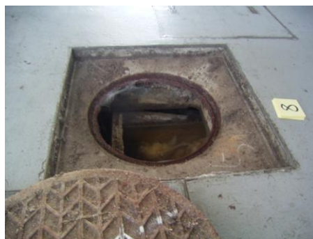
欠陥事例写真⑤
