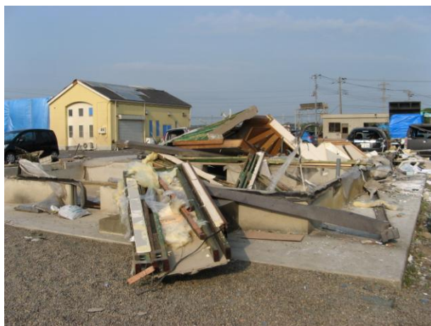
□ 全壊したツーバイフォー住宅
