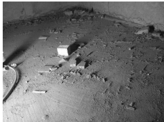
床下に残る木片・木くず・コンクリート粉
