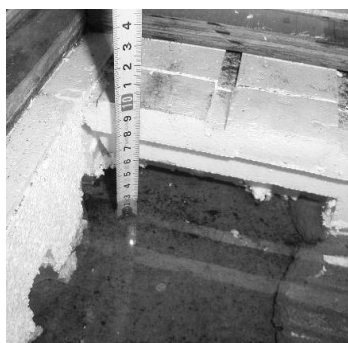
床下に地下水が溜まった住宅例
