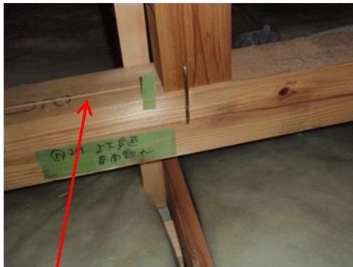
梁上下面の貫通割れ
