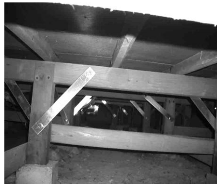
悪質リフォームの一例(1階床下の不要な金物)
