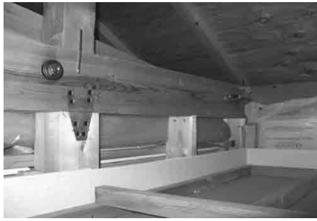
天井裏において間仕切壁 上部に断熱材が無い状況
