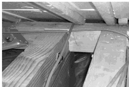
梁の収縮量が違う為、梁天端が不揃い
