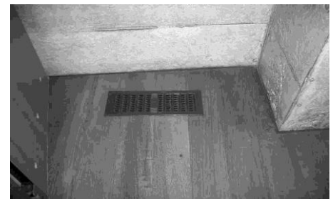
床の給気孔 (床下から給気している)
