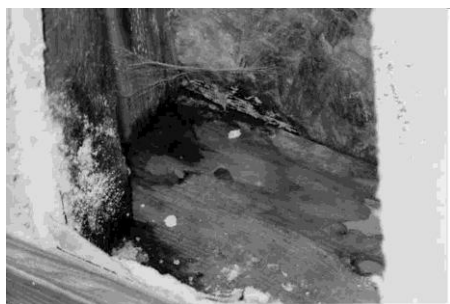
壁内部の結露とカビ
