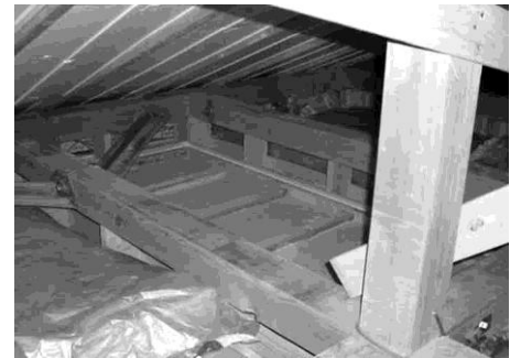
天井裏において部分的に断熱材が無い
