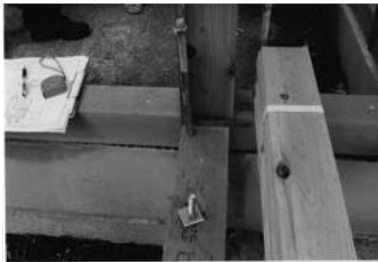
ホールダウンアンカーの芯ずれ
