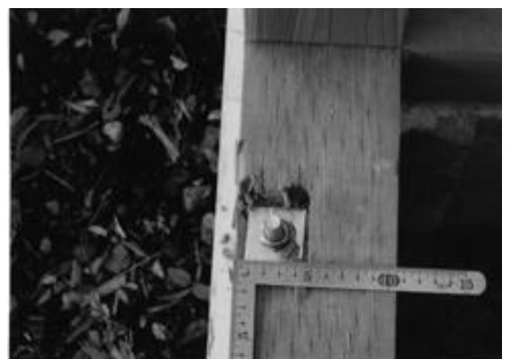
アンカーボルトの芯ずれと土台の欠損
