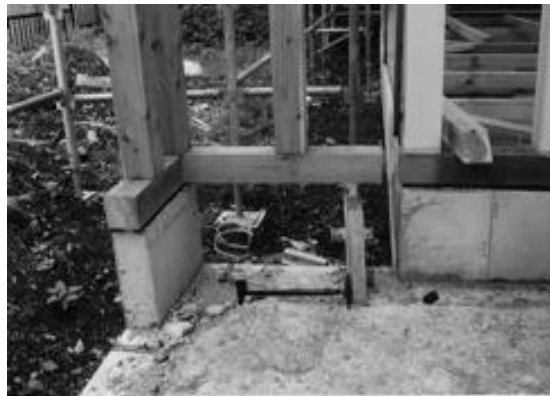
基礎のない外壁、 長さ不足で接続のない土台
