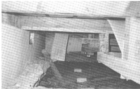
建物の外から見てもわからない床下の地盤は、450mm以上も沈下している
