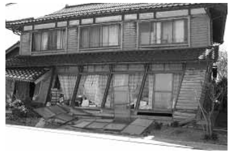
( 能登半島地震被災の様子-3 )
