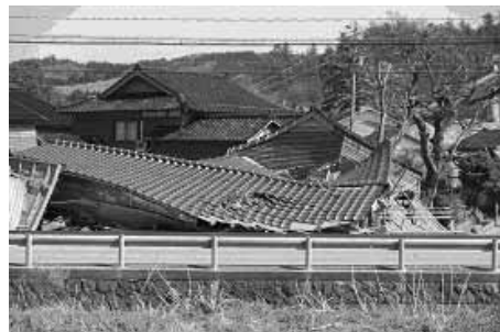
( 能登半島地震被災の様子-4 )
