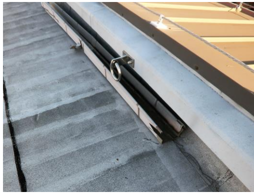
(写真-6) 屋上の軒樋の飛散
