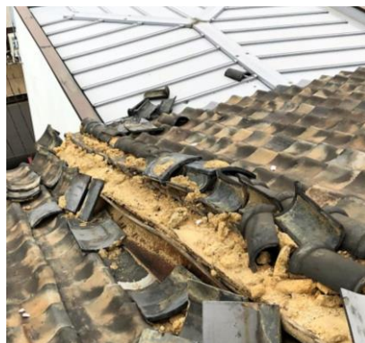
(写真-3) 屋根瓦の飛散
