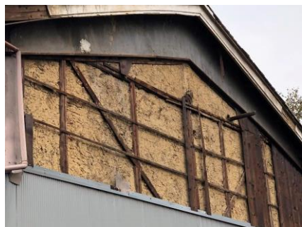
(写真-4) モルタル外壁が落下
