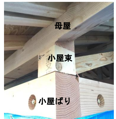
(写真-5) 「小屋ばり」「小屋束」「母屋」仕口の緊結不良
