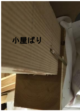
(写真-4) 「小屋ばり」継手の緊結不良
