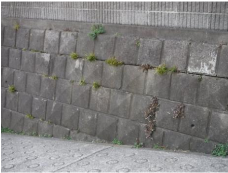
間知石の隙間から雑草が生えている
