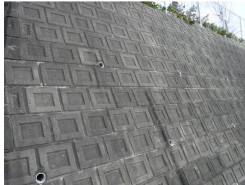
布積の間知石。間知石同士がしっかりと噛み合っている。
