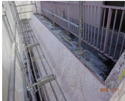
写真2: 斜壁のモルタル(塗装)のクラック・浮き現象
