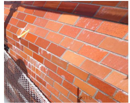
写真1: 斜壁のクラックやタイル目地からのエフロ現象
