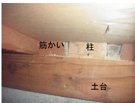
木造住宅の柱、土台、筋かいの取り付け状況(床下から撮影)。新耐震基準適用以降も65パーセントが釘打ち程度(金物未使用)。
