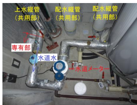
パイプスペース内の共用部と専用部
