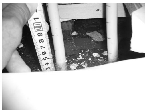
洗面所の床下に溜まった水
