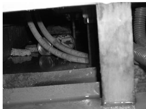
床下に散乱するごみ。 杜撰な工事の様子が窺える
